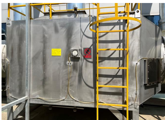
活性炭处理设施
