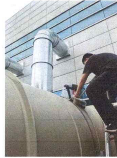
FQ-606832 废气处理设施进口
