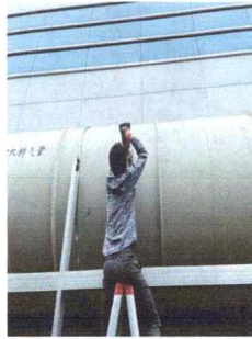
FQ-606832 废气处理设施进口
