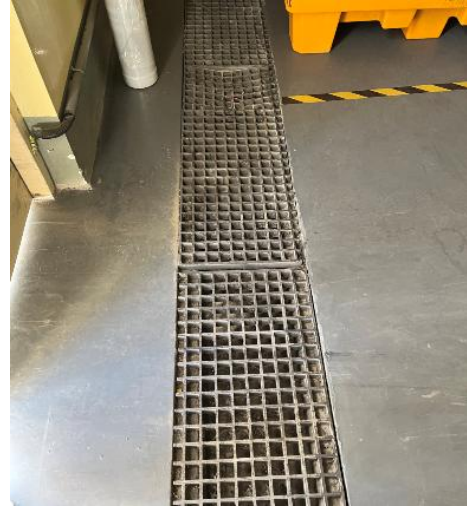
危废仓库地面收集沟
