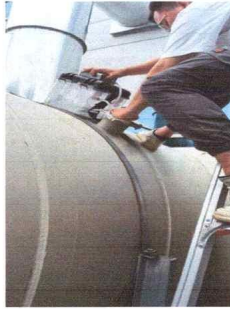
FQ-606832 废气处理设施出口
