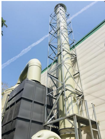
浇注车间废气排放口
