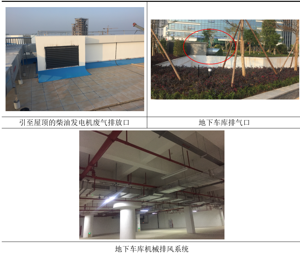
图 3-7 废气治理设施照片
