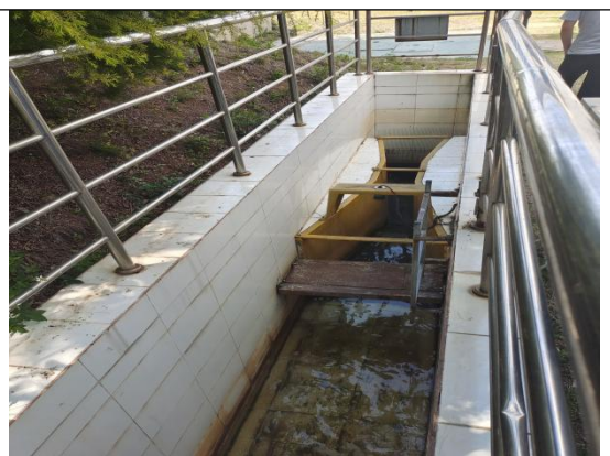
生产废水排放口
