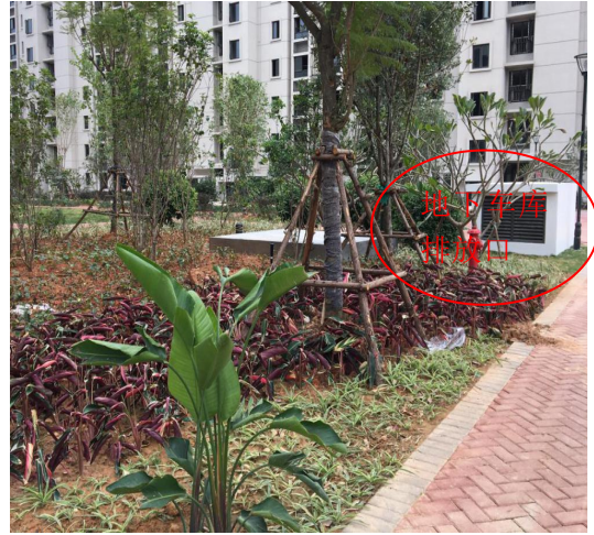
地下车库排风口
