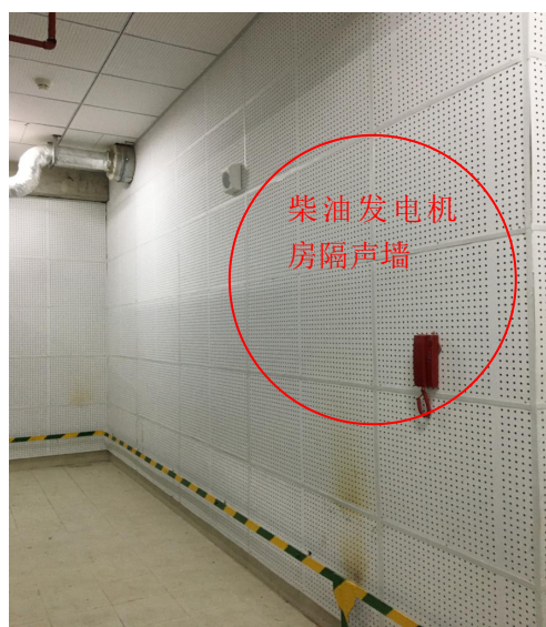
柴油发电机房隔声墙
