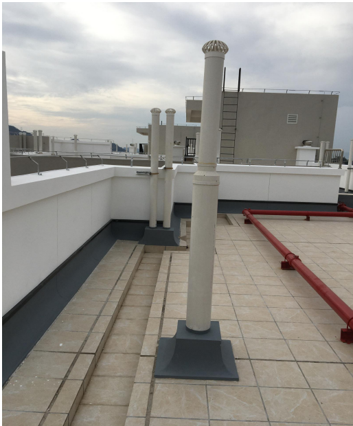
住宅楼油烟排放口
